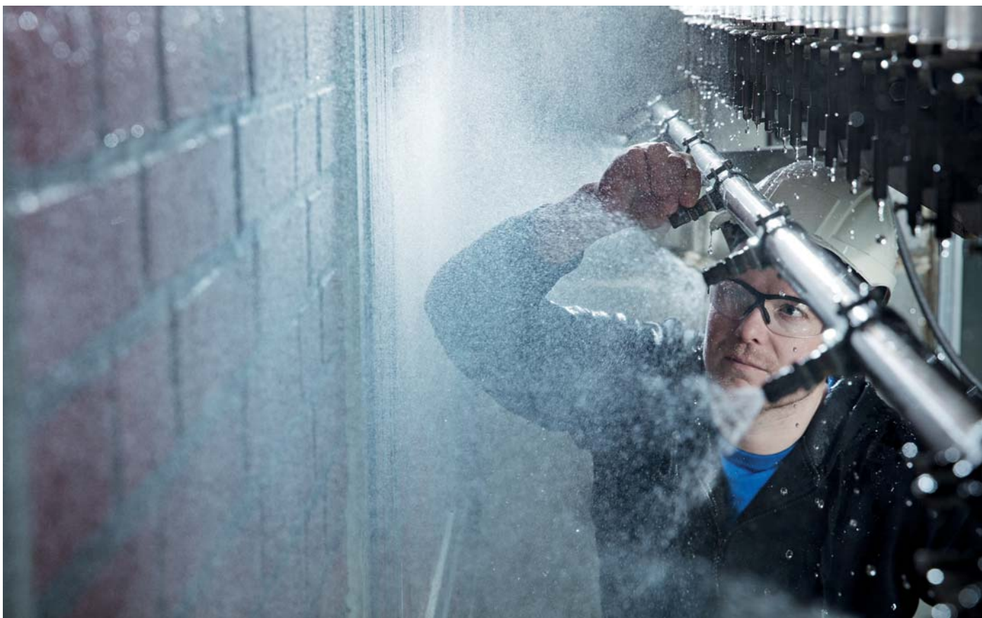
TEGLMURVERK. Fredrik Slapø forbereder slagregnprøving av teglmurverk. Den mest regntette teglfasaden oppnår du ved muring med våt mørtel. Foto: Geir Mogen.
