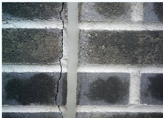
Feil utførte vertikale bevegesfuger i murverk kan gi utilsikta påkjenning på murverket og oppsprekking.
