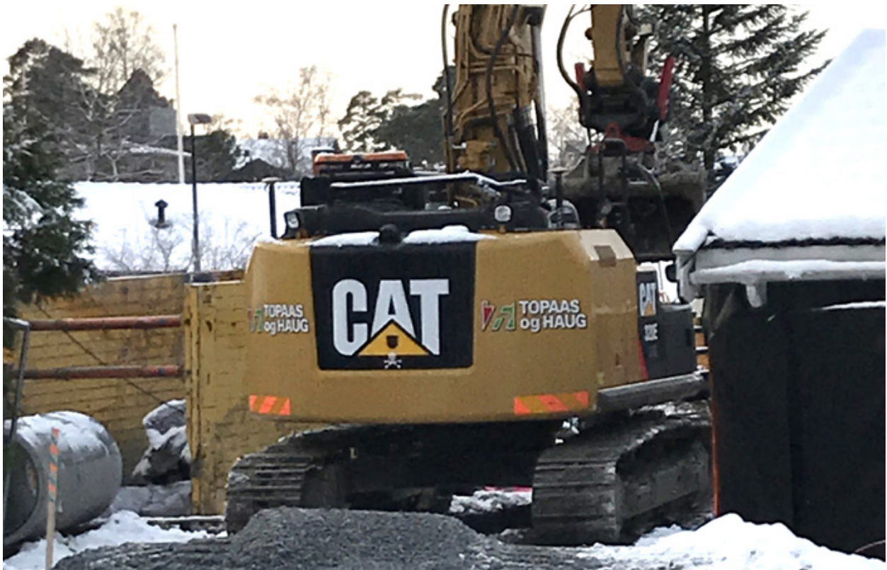
Byggesaksavdelingen i Kommunal- og moderniseringsdepartementet fikk se hvor krevende det kan være å separere avløpsledninger i et område som senere er blitt bebygget.
