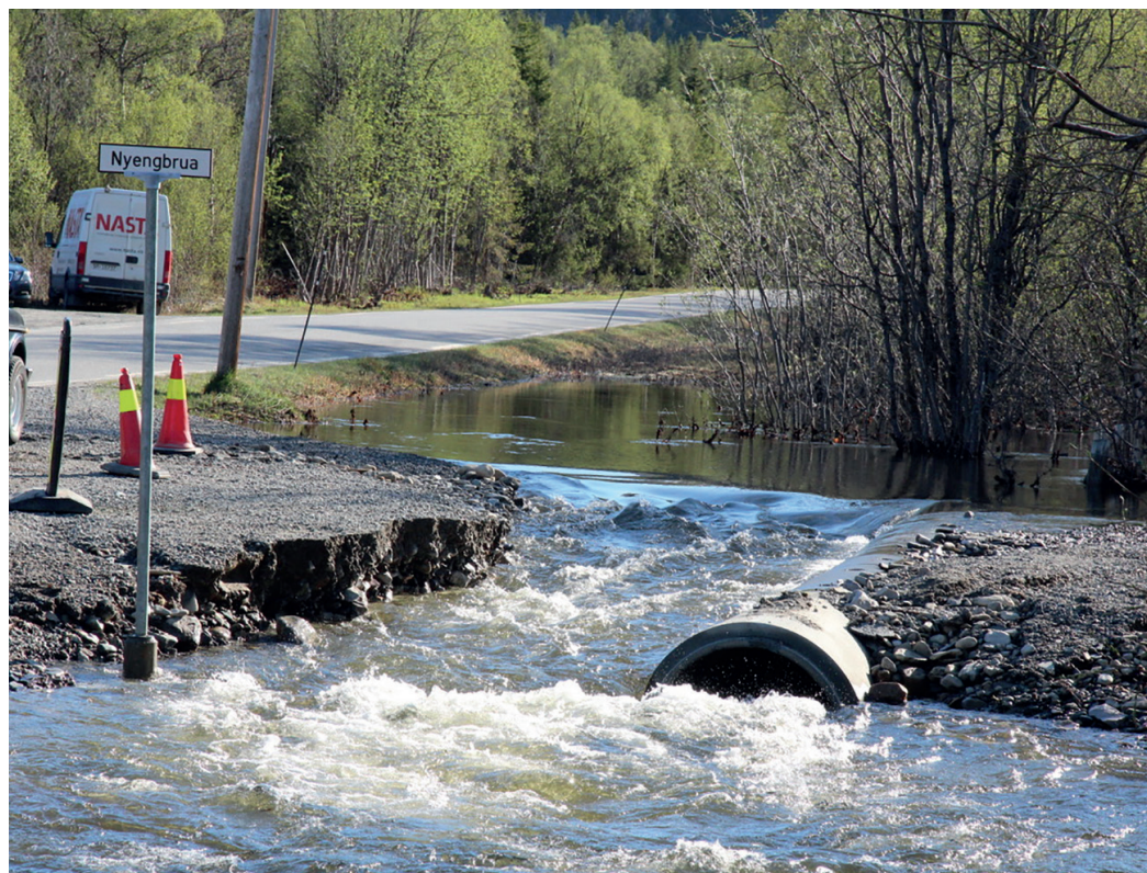
Skade på kulvert på grunn av flom i Kviby.
