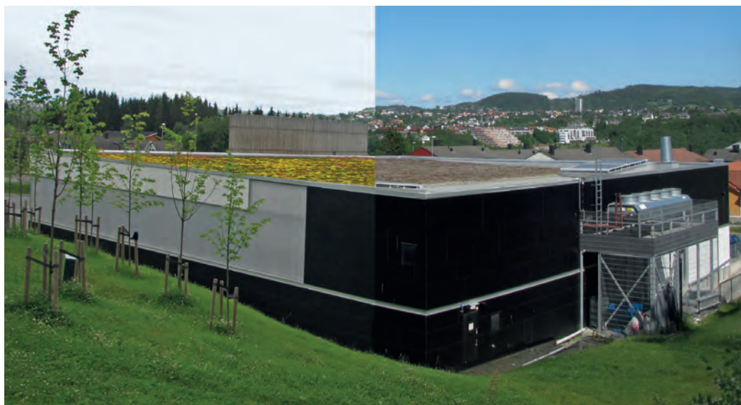
Sedumtak i Trondheim før og etter en litt for tøff vinter for taket. Høyre del av taket er fotografert ett år etter den venstre delen. Begge foto tatt i juli. Illustrasjon: Klima 2050
