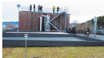
Overvann: Allerede i dag kan overvann være en utfordring for rensanlegg. På Hovringen rensanlegg pågår et prosjekt for å teste grønne tak som tiltak for å håndtere overvann. Bak står Klima 2050, i samarbeid med Trondheim kommune. Foto: VEGARD EGGEN
