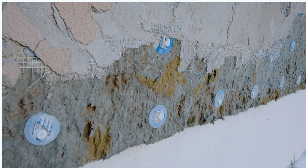
Små manglar blir fort avslørt og får store konsekvensar når værpåkjenninga er stor. Avslutning mot sokkel er eit ekstra sårbart punkt. Foto: Tore Kvande.
