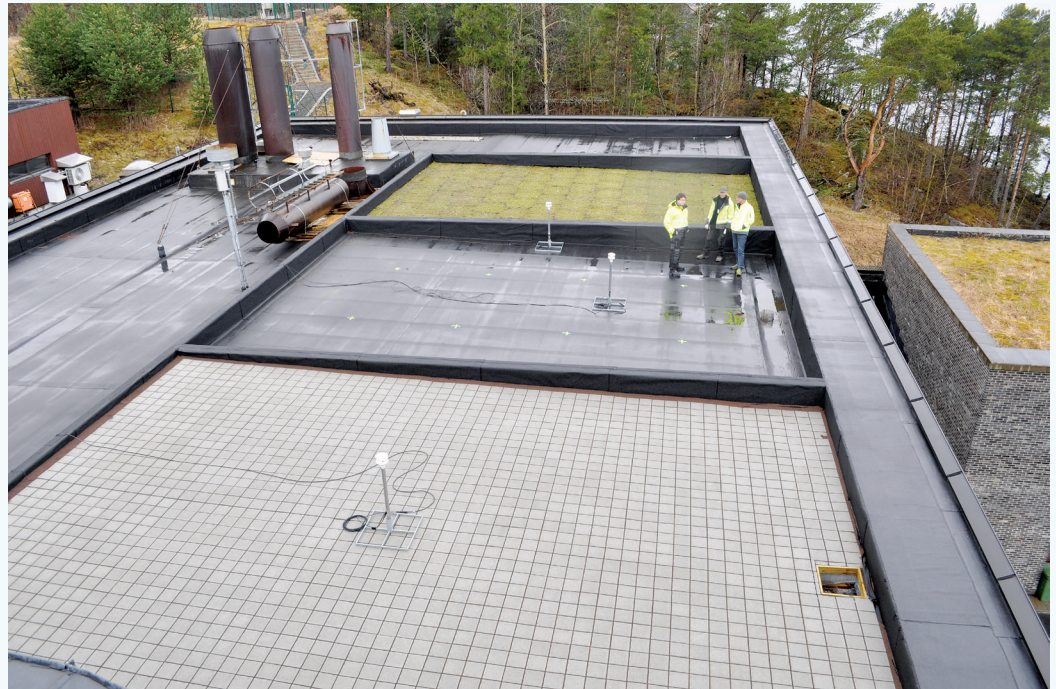
Trondheim kommune har sammen med Klima 2050 etablert en egen feltstasjon på Høvringen avløpsrensaneanlegg for utvikling av blågrønne og blågrå tak som aktive element i framtidig overvannshåndtering. Foto: Tore Kvande.
