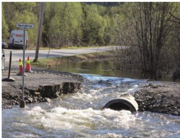
Skade på kulvert på grunn av flom i Kvibøy.
