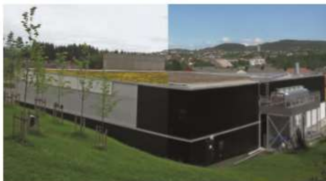
Sedumtak i Trondheim før og etter en litt for tøft vinter for taket. Høyre del av taket er fotografert ett år etter den venstre delen. Begge foto tatt i juli. Illustrasjon: Klima 2050
