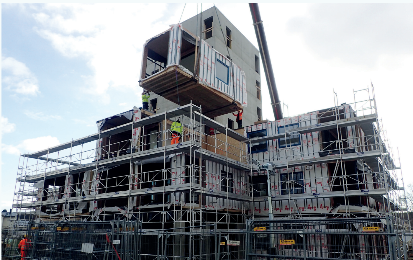
Utenlandsproduserte bygningsmoduler er ikke nødvendigvis prosjektert av aktører med lokal klimakunnskap om den aktuelle byggetomten.
