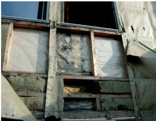
Figur 11.2.1 Mangelfull tetting rundt vindu, som har gitt lekkasjer og oppfukting av veggen under vinduene. Foto: SINTEF Byggforsk
