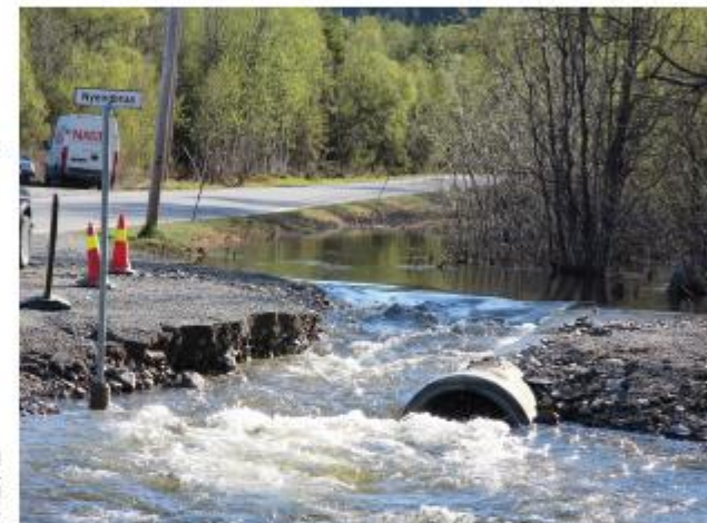
Skadepå kulvert på grunn av flom i Klvby.
