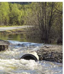
Bilde på kulvert på grunn av flom i kvil.
