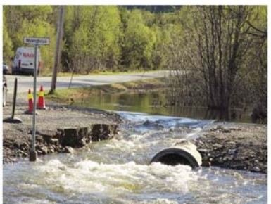
Bilde på kulvert på grunn av flom i kvil.
